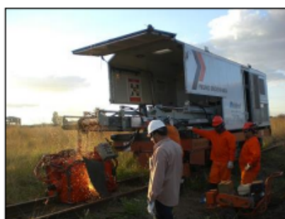
Figura 4 - Container de soldagem elétrica (Thiago Viana, 2011)
